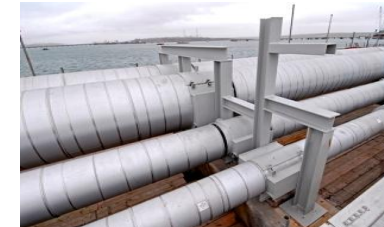
LNG Pipe Jacket
